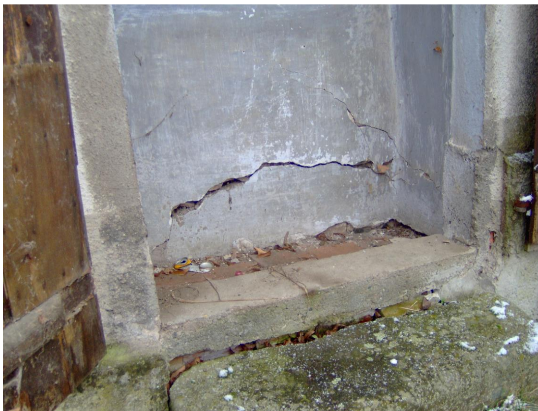
Obr. č. 3 : Detailní pohled na kapličku z čelní strany - pohled na výraznou trhlinu ve spodní části
