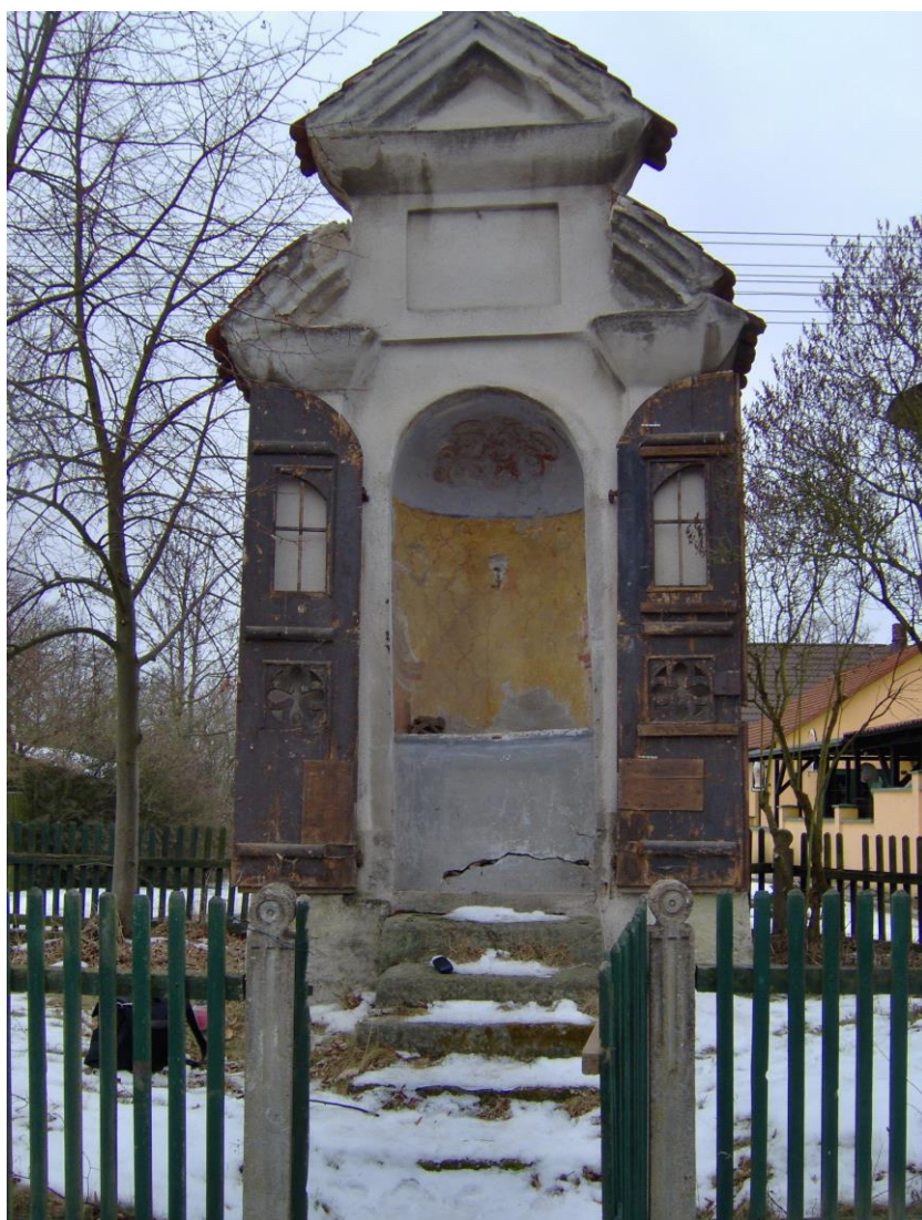
Obr. č. 1 : Pohled na kapličku svatého Jana Nepomuckého z čelní strany ... zhruba východní pohled → zřetelné je výrazná trhlina ve spodní části způsobena nakloněním objektu
