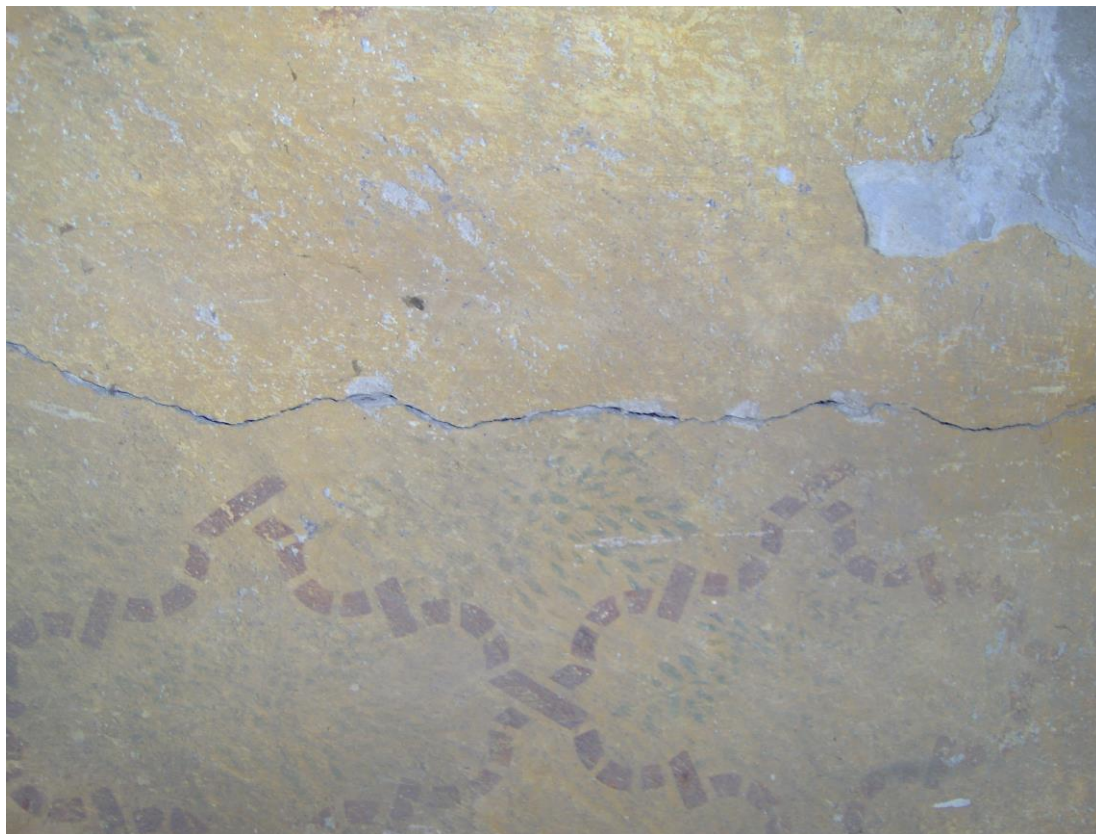
Obr. č. 4 : Detailní pohled na kapličku z čelní strany - pohled na vodorovnou trhlinu vyvolanou vznikem tahových sil při naklonění
