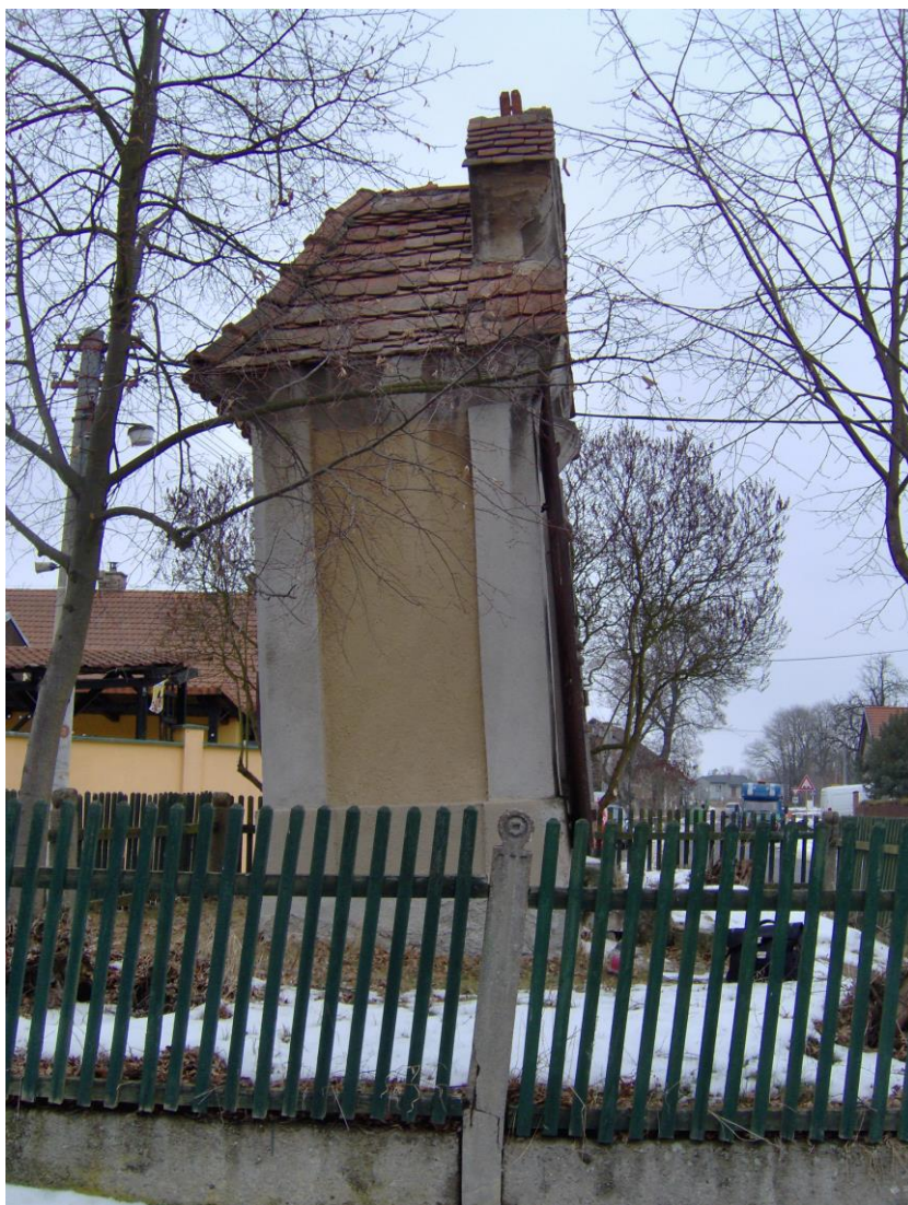
Obr. č. 2 : Pohled na kapličku svatého Jana Nepomuckého z boční strany ... pohled z jihu → naklonění kapličky je značné - odklon dosahuje v horní části zhruba 150 mm
